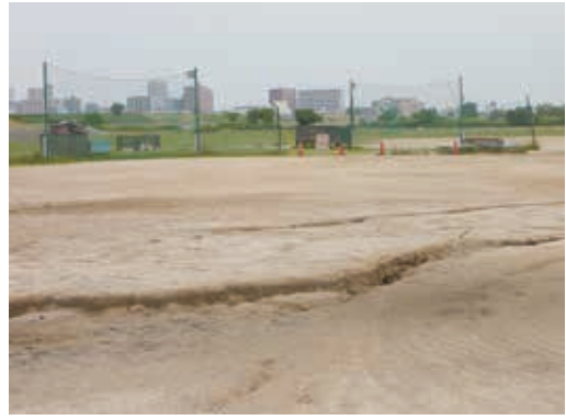
写真1-4-2 亀裂が入ったグラウンド 江戸川河川敷緑地の野球グラウンドでは、地震による亀裂や陥没が発生した。(河原 2011年7月4日 市川自然博物館収蔵)
