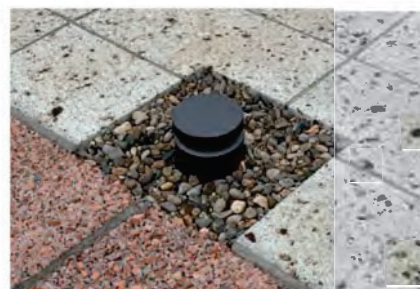
写真 33 照明設備の整備事例（武蔵国分寺跡）
