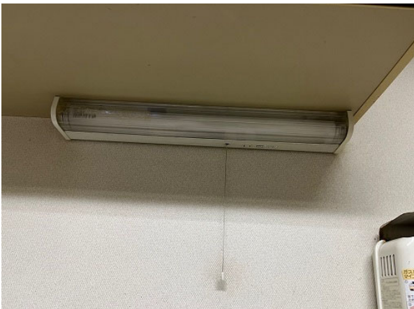
大野 No.7 湯沸室キッチンライトアップ
