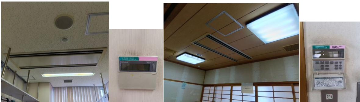
ACP-3-1 (女子更衣室) リモコン ACP-3-2 (和室) リモコン
