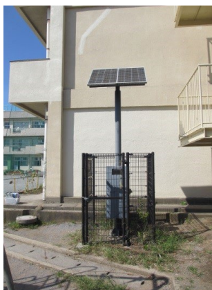
中山小学校の太陽光発電設備
