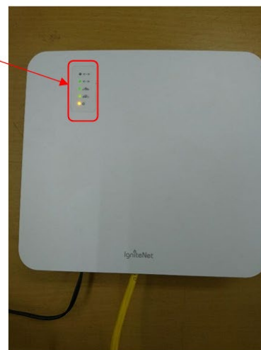
WiFi 機器電源投入後の状態
