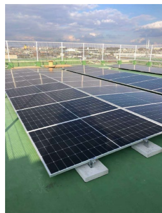
菅野小学校の太陽光発電設備
