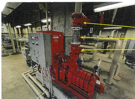
屋内消火栓ポンプ
