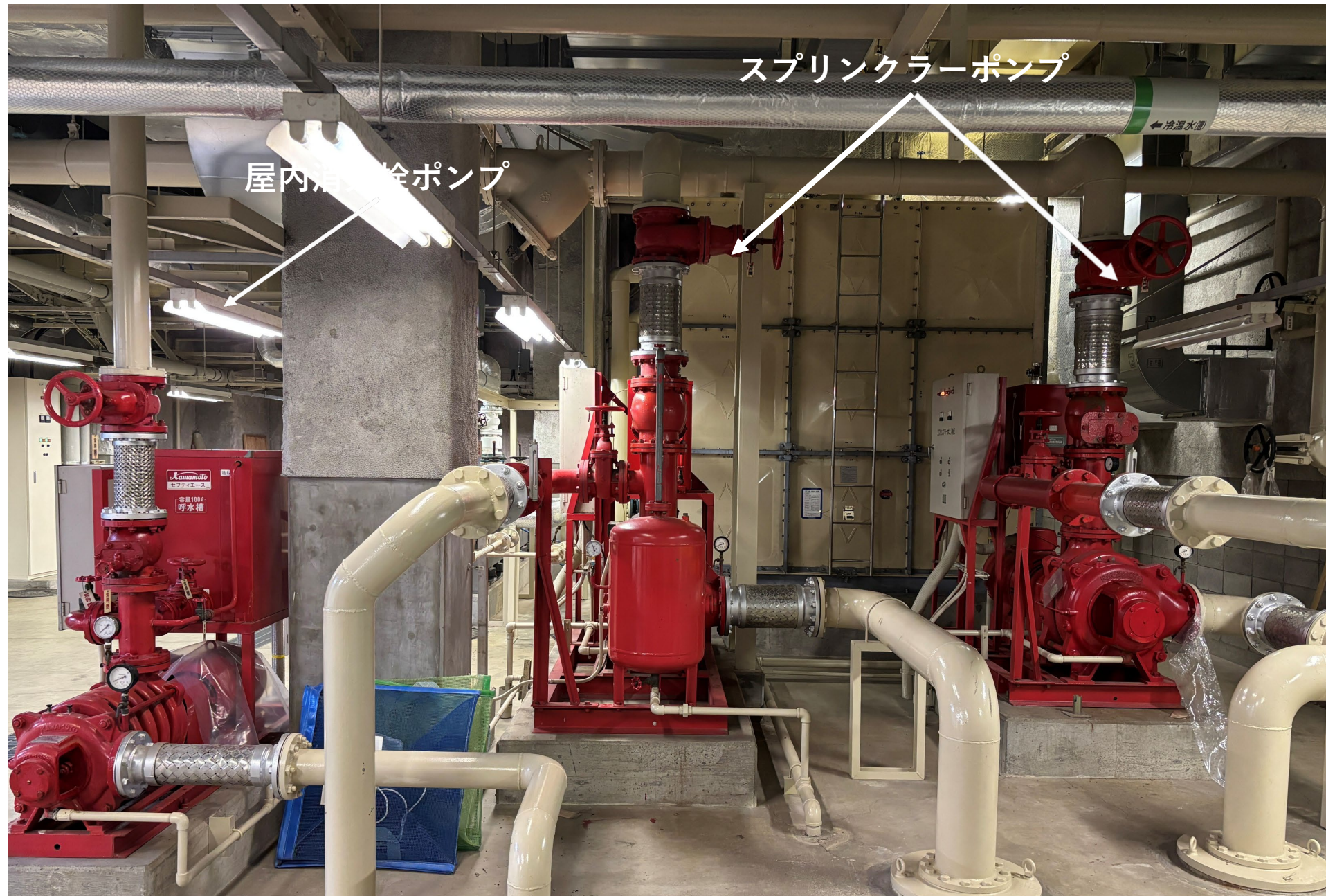
スプリンクラーポンプ及び屋内消火栓ポンプ 現況①
