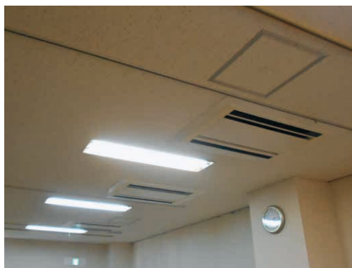
△改修前（南行徳公民館空調・照明）
