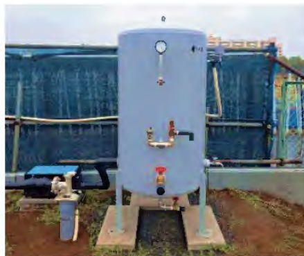
△新設の井戸 （農業用灌漑用水設備設置事業）
