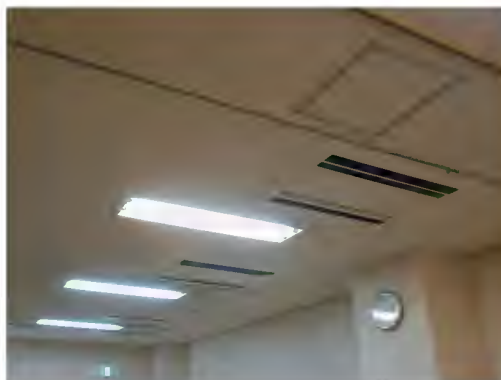
△改修前（南行徳公民館空調・照明）
