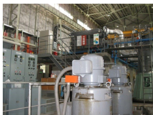
■ 菅野ポンプ場の施設の様子
